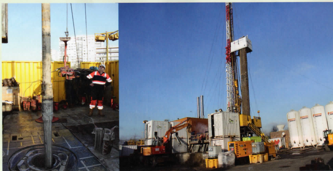
Un troisième puits est en cours de forage à Ris-Orangis afin d'augmenter les ressources géothermiques du quartier.
