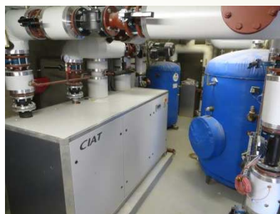
Sous station du chauffage et de la climatisation
