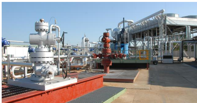
La centrale de géothermie de Soultz-sous-Forêts sera inaugurée aujourd'hui. PHOTO DNA - JOLAIN
