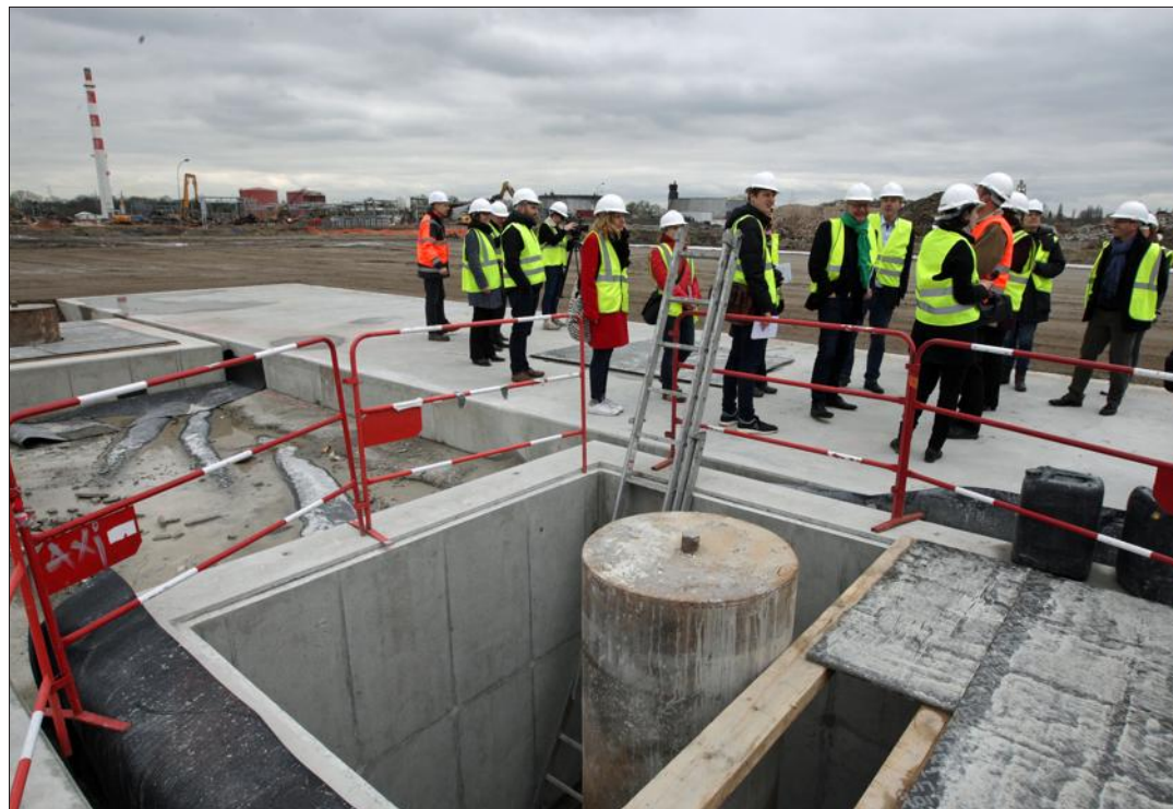
La plateforme en béton et le trou de forage sur le site de l'ancienne raffinerie accueilleront, dès le mois de juin, la machine foreuse qui permettra de poser les tubes jusqu'à 4 000 m de profondeur. Photo L'Alsace/Dominique Gutekunst
